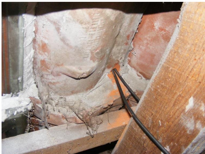
Manglende samarbejde mellem murer og elektriker
